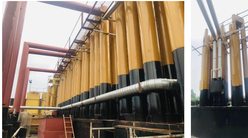
Hệ thống cyclo rửa, lọc khí Syngas
