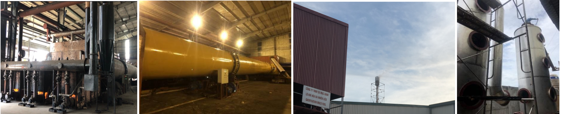
Hệ thống xử lý khói khí thải của quá trình đốt khí tận dụng nhiệt và sấy rác
